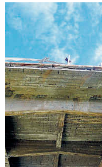
Malridotto. Un particolare del viadotto di Targia, a Siracusa
